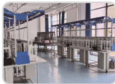
电工电子实训室
